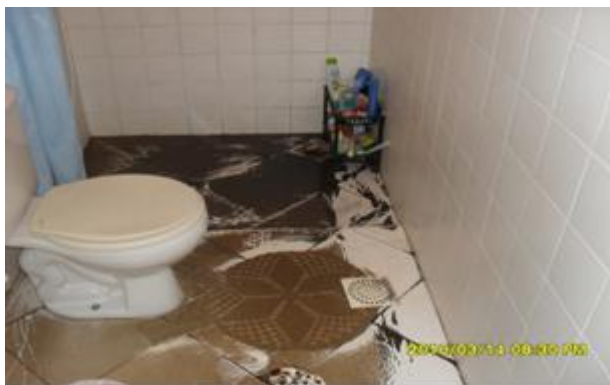
Figura 5 - Banheiro com retorno de esgoto Fonte: DAE Bauru
