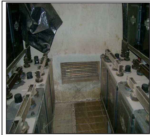
Figura 2 - Entrada de ar da Sala de baterias analisada em uma indústria na região Metropolitana de Curitiba. Fonte: Autor (2008).
