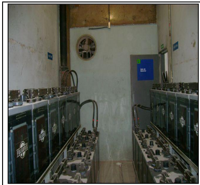
Figura 1 - Saída de ar da Sala de baterias analisada em uma indústria na região metropolitana de Curitiba. Fonte: Autor (2008).
