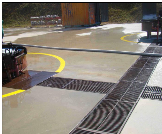
Figura 11 – Canaletas por onde vaza a água de combate ao incêndio, fonte: Sampling Planejamento
